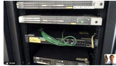
サーバラック 点検作業
